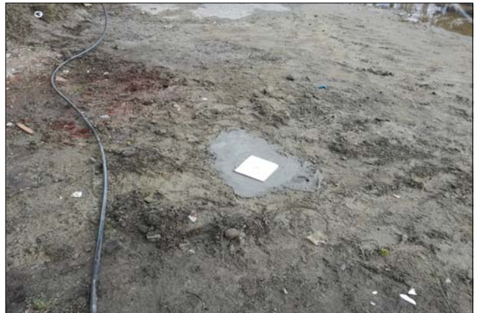
pozzetto di protezione e chiusura
