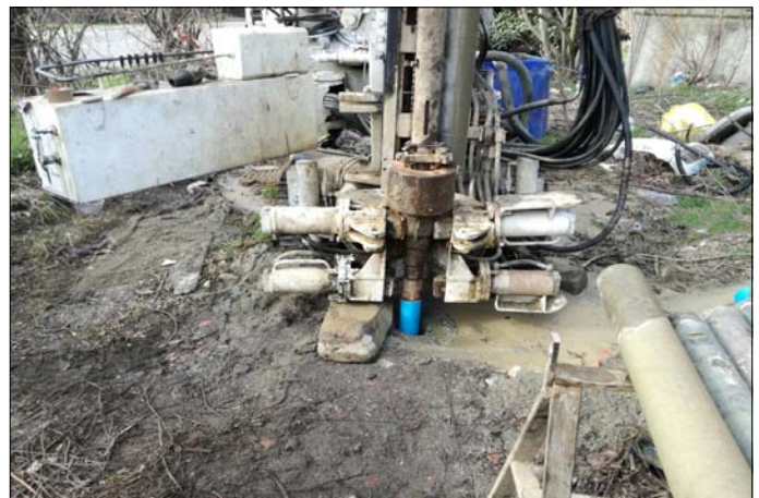
foro allestito con tubo piezometrico
